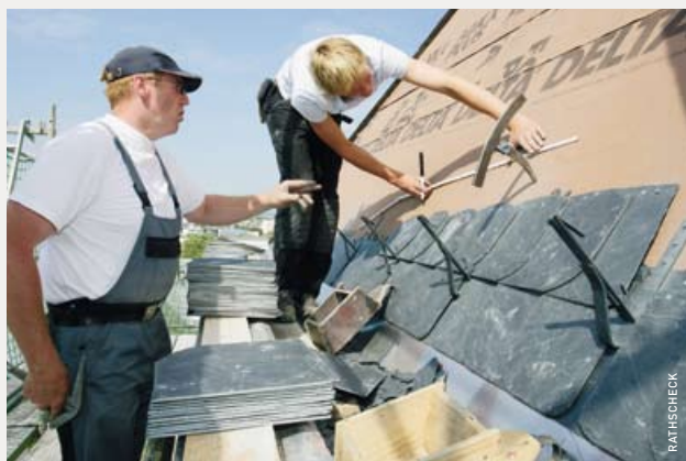
▲ Dachdeckermeister Hubertus Becker zeigt dem Auszubildenden Roman Büssing, wie das Fußgebinde über dem Reparaturgebinde gedeckt werden muss
